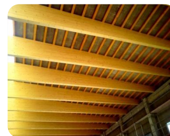
Nová střecha na sportovní hale v objektu bývalé cihelny v Modřicích: Montáž lepených vazníků, KVH roštu, cetris záklopu, zateplení a foliové povlakové krytiny. Cena: cca. 2.100.000,00Kč Investor: Cimod s.r.o.
