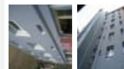
Zateplení BD Jana Uhra 18- dvůr Výměra: 730m 2 , Systém: Ceretherm Premium Cena: 1.250.000,00Kč Investor: Ezra reality, Projekt: Zelená úsporám Provedení vč. lakovaných parapetů, svodů.....
